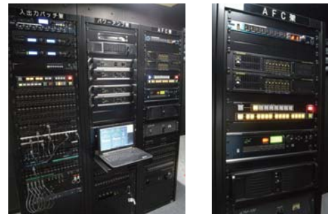
入出力パッチ架、電力増幅器架、AFC架
