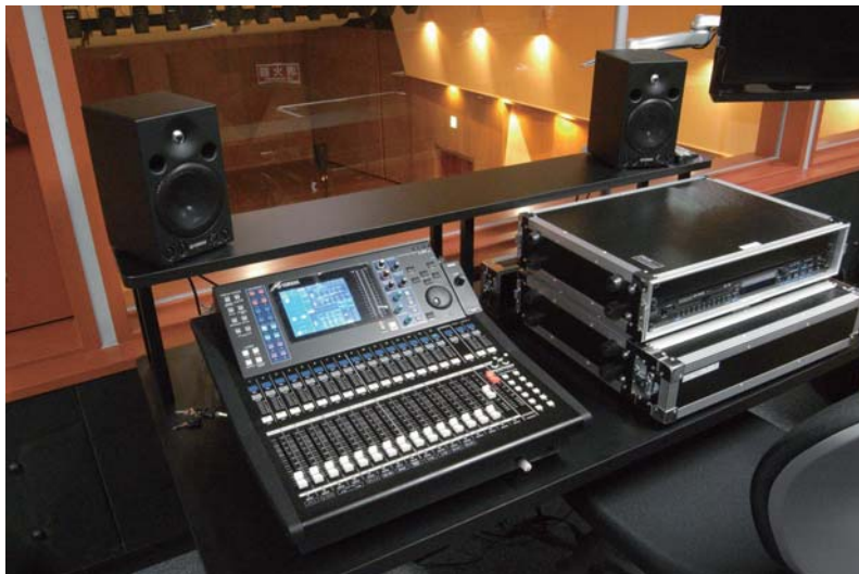
音響調整室内
