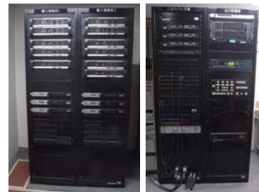
電力増幅器架 No1, 2
