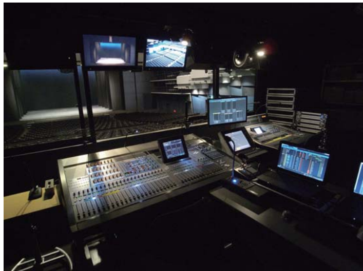
音響調整室内
