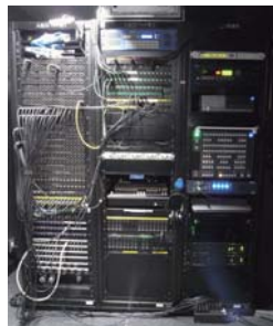
入出力パッチ架、出力制御架
