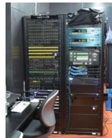
入出力パッチ架、出力制御架
