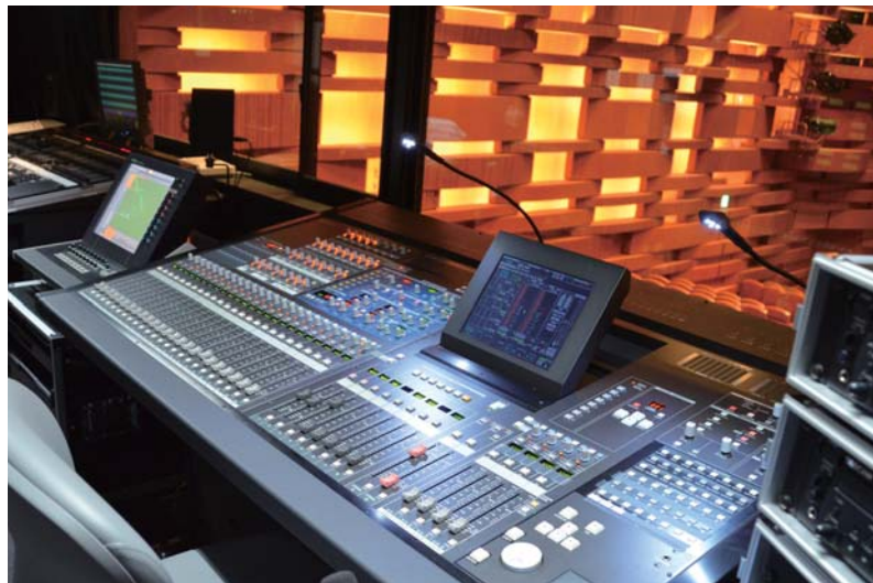
音響調整室内
