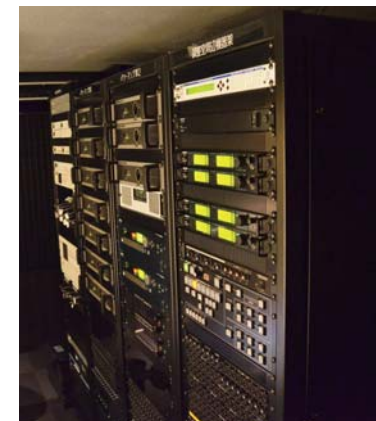
パワーアンプ架・出力制御架
