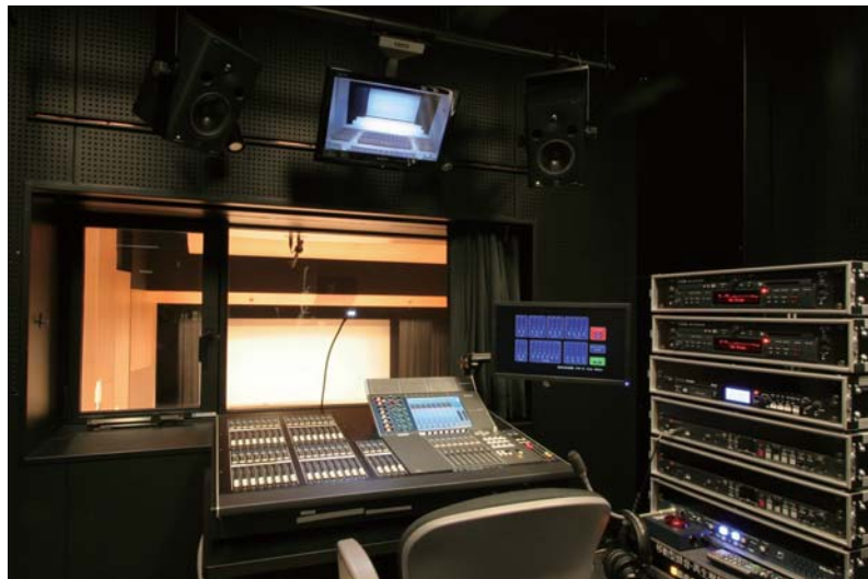
音響調整室内
