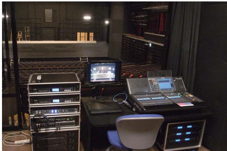
音響調整室内
