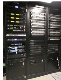
出力制御、パワーアンプ架
