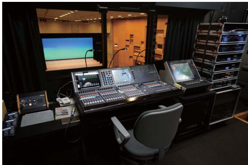
音響調整室内
