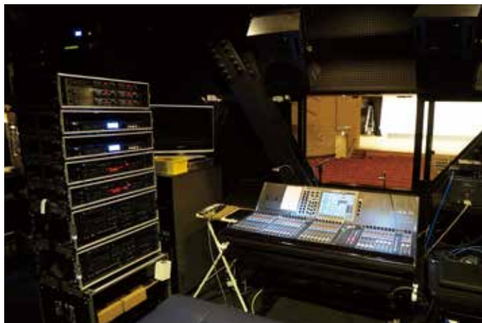
音響調整室内
