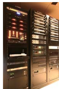
出力制御架、電力増幅器架
