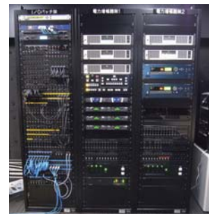
左から : I/O パッチ架、電力増幅器架 No1, 2
