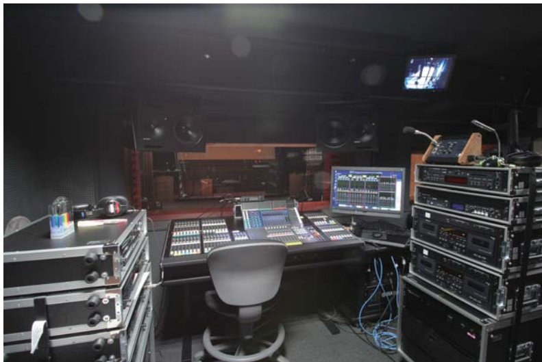
音響調整室内
